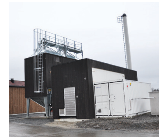
Bioenergisentralen med container for spisslast (gass) foran og siloer bak, leverer cirka 1,9 GWh årlig. Foto: Ringeriks-Kraft Nærvarme
