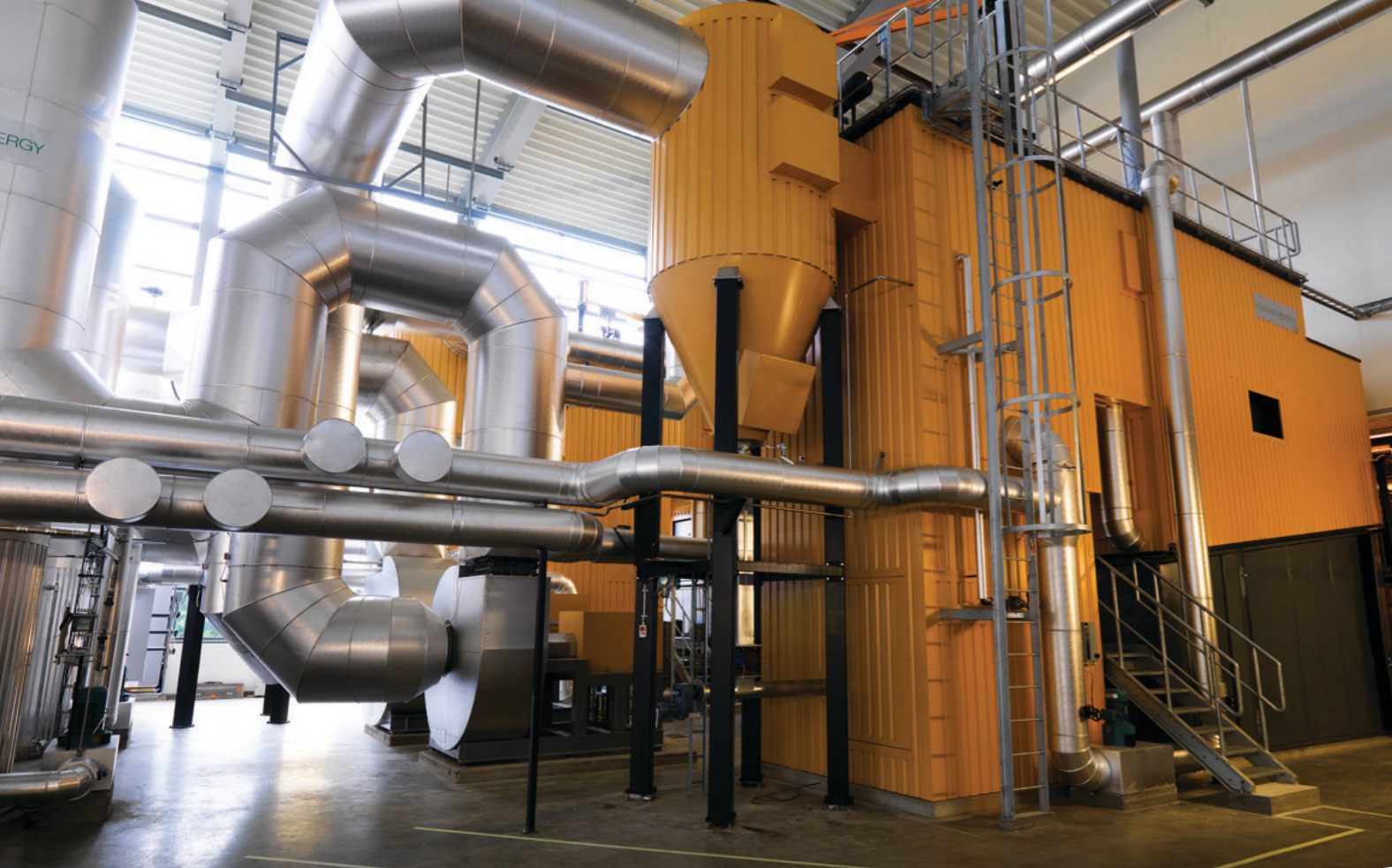
Akershus EnergiPark Foto: Anders Henriksen
